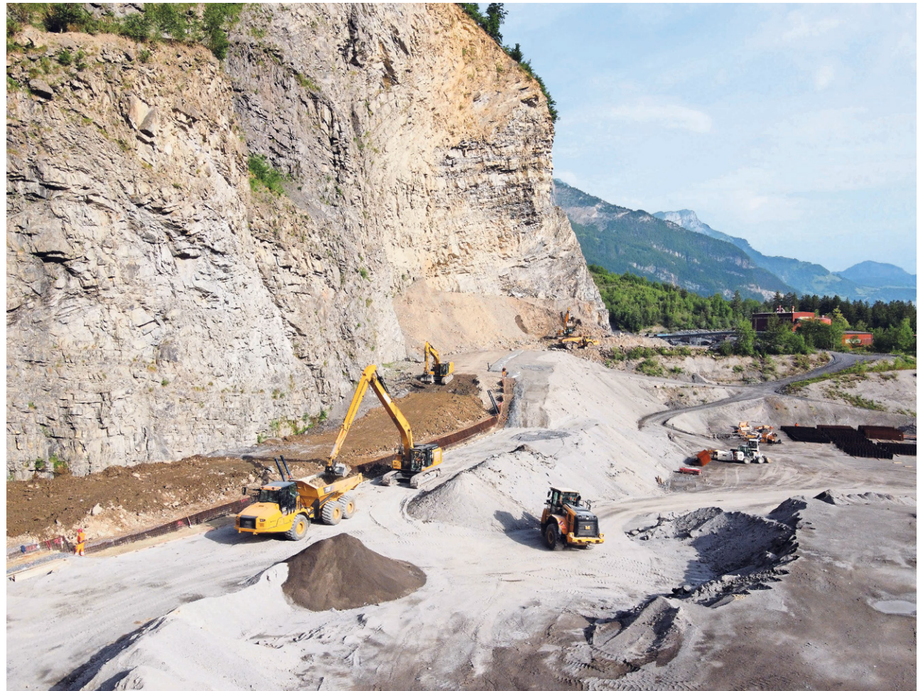
Die Deponie Eielen wächst in die Höhe. Dies erfordert Baumassnahmen hinsichtlich der Randabdichtung. FOTO: ZVG
